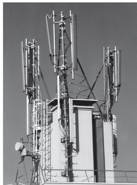
Antennes sur toit... à Courbevoie
