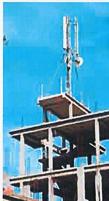
Quand les ondes vont plus vite que la construction...
