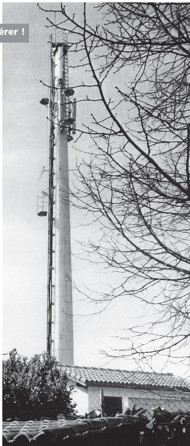
Région Sud-Ouest, pylone de 30 mètres de hauteur, 6 émetteurs, à 6 mètres des habitations
