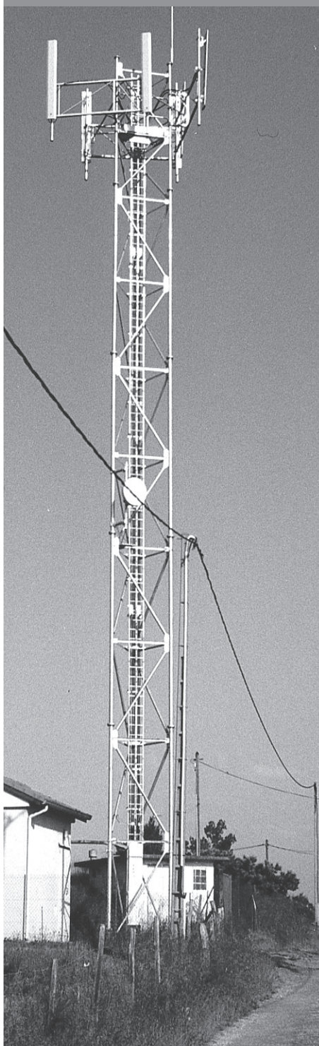
Région Centre, pylône 20m de haut, à proximité d'habitations
